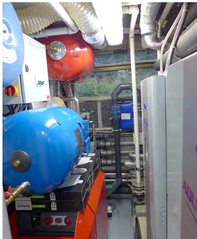
機械室 狭い空間にタンク、空調、洗濯機などがぎっしり
