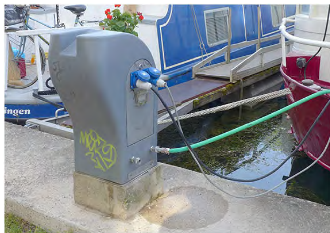
電源と水源 ディジョン港で。上が電気のコンセントで下が水道の接続口。
