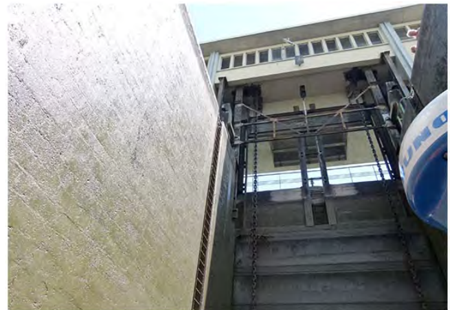
ソントレ運河最後の閘門減水後 落差が10.8mもあるので操作室はるかに上。
